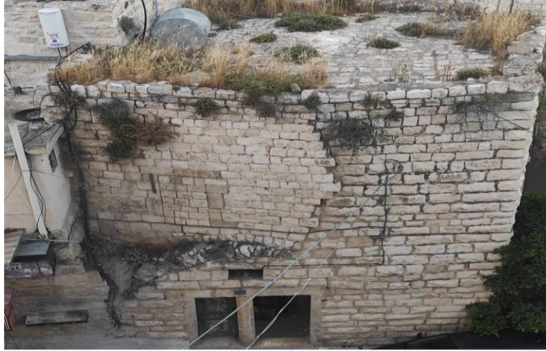
الشكل 3: مبنى تاريخي متضرر من زلزال عام 1927م. مدينة بيت جالا المصدر: تصوير الباحث 2023-12-21
